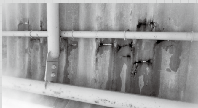
テラス屋根被害
