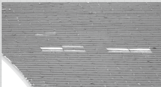
屋根材の補修跡
