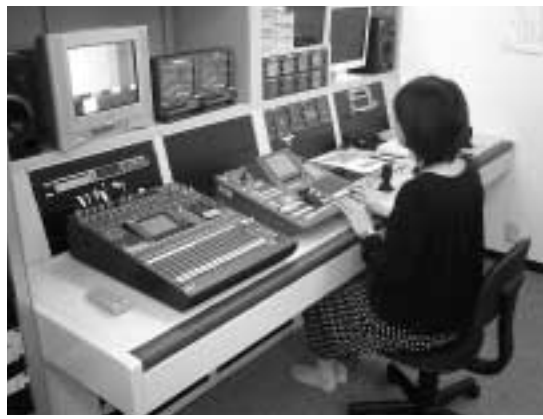
議会中継用設備
