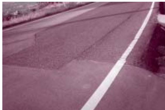
補修あとの目立つ舗装
