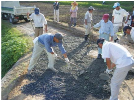
ろばんしきなら 路盤敷均し作業に汗をかく (宮前一集落)
