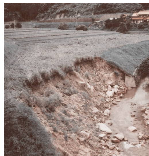
早田地内の被災現場
