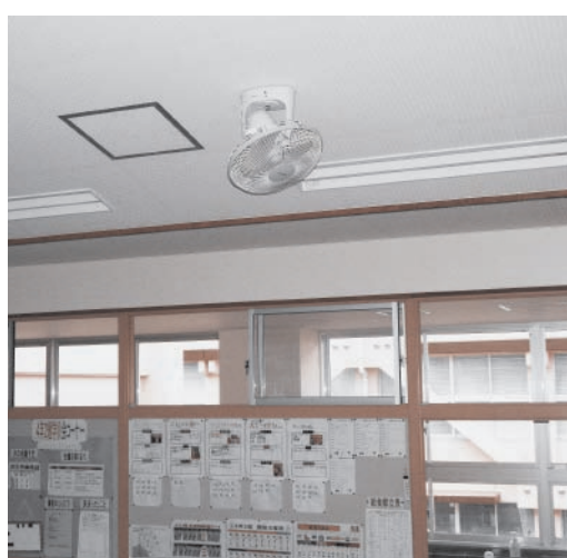
会見小学校の天井扇
