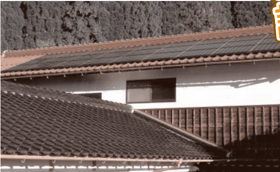
住宅用太陽光パネル
