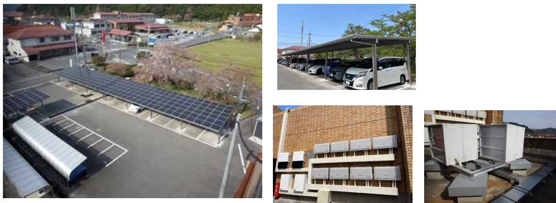
写真 3 法勝寺庁舎のソーラーカーポート及びパワーコンディショナ・蓄電池導入
