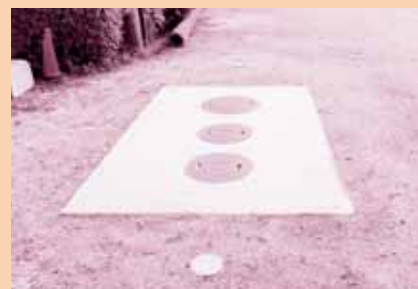
下鴨部公民館合併浄化槽
