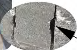
歩道の側溝の隙間
