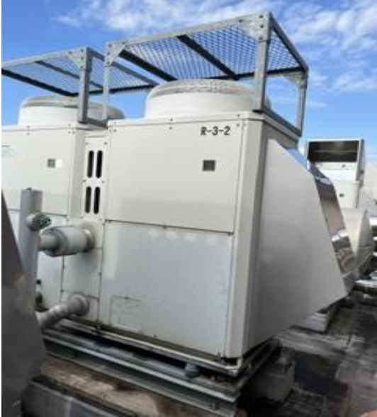
⑤給湯用ヒートポンプチラーR3-2NO.1系統 部品交換修理
