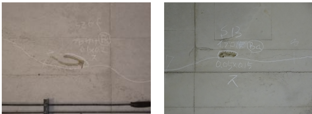
写真 4.3 ひび割れ沿いのうき(左:S026 Ⅱb判定、右:S013 Ⅲ判定)
