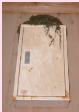
配電盤の上に作られたオオルリの巣
