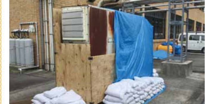
現在の非常用電源設備
