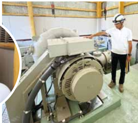
小水力発電機
