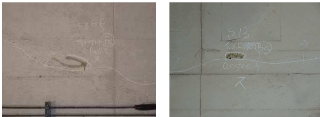
写真 4.3 ひび割れ沿いのうき(左:S026 IIb 判定、右:S013 III判定)
