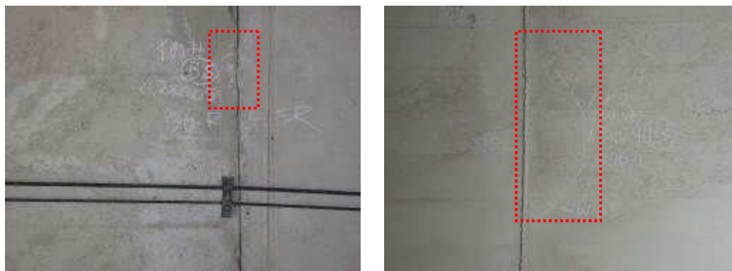
写真 4.2 左:打音異常のみ S006、右:打音異常なし S016(いずれもⅡ判定)
