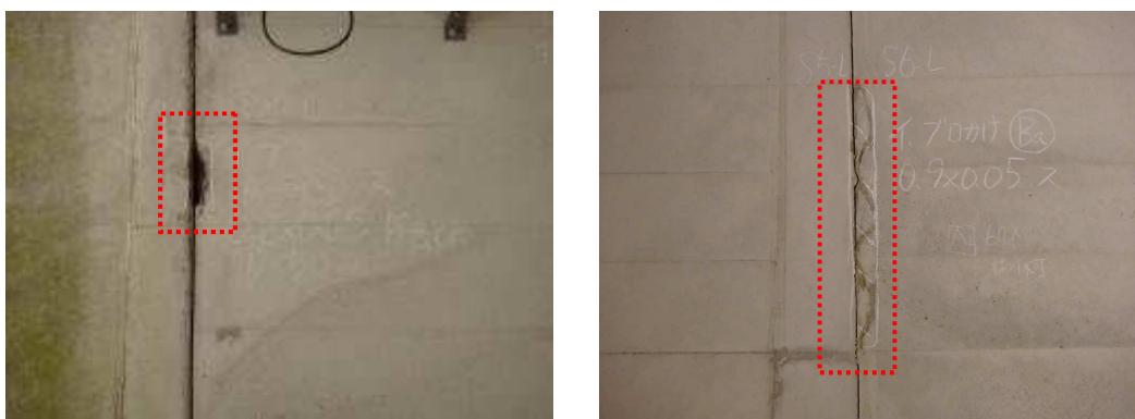
写真 4.1 目地部のうき 左:除去済み S002(Ⅰ判定) 右:閉合しかけ除去不可 S006(Ⅲ判定)
