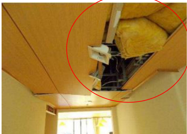
① 椿ユニット天井剥がれ
