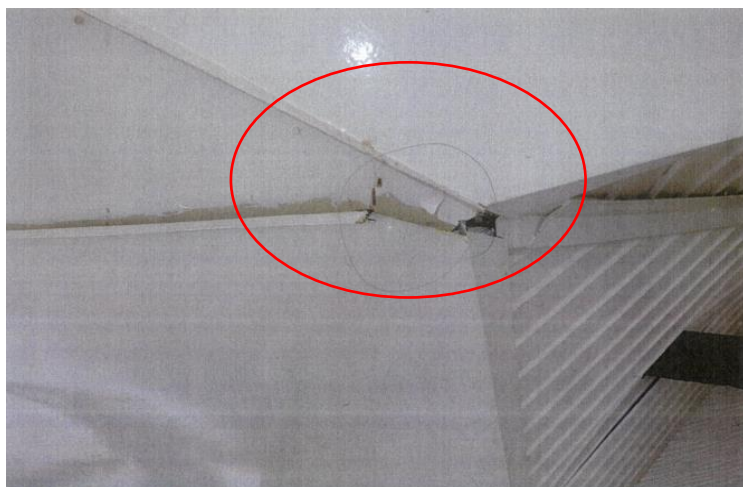
⑦ 屋根鉄板剥がれ
