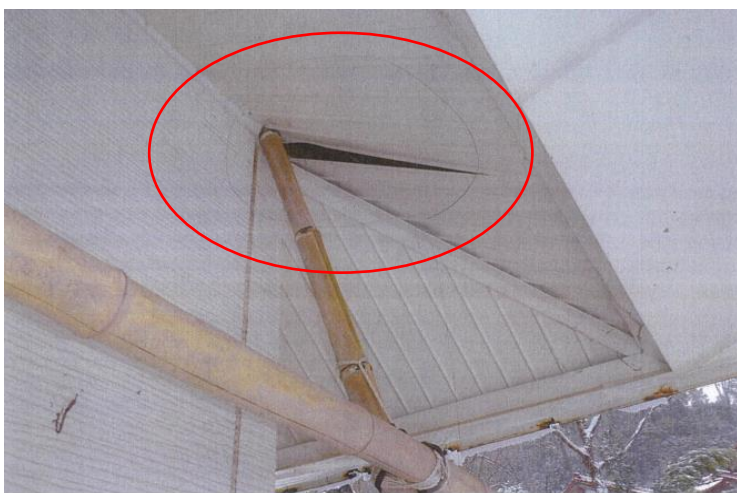
⑤ 屋根鉄板剥がれ
