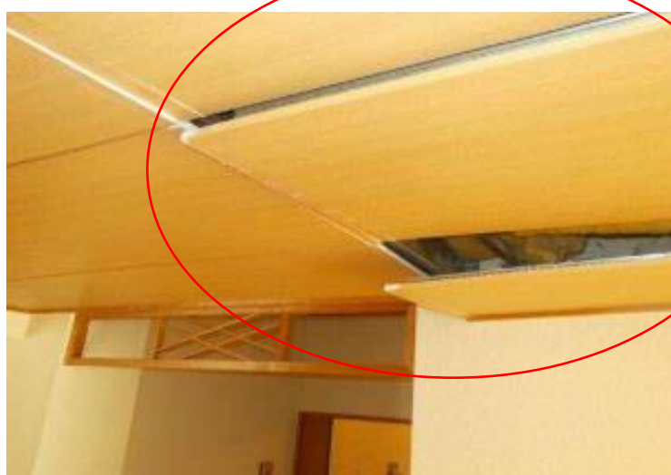
② 杏ユニット天井剥がれ
