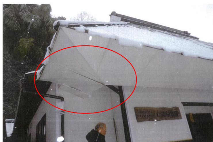
⑥ 屋根鉄板剥がれ
