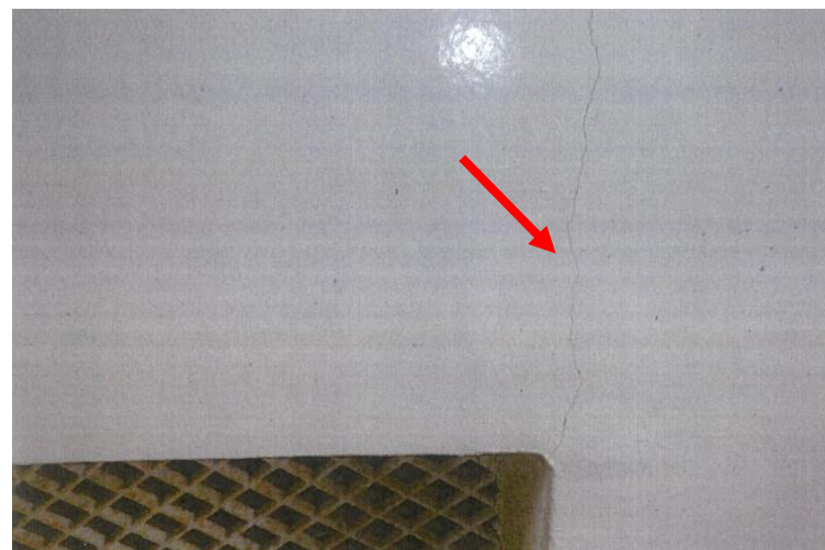
⑧ 外壁ひび割れ
