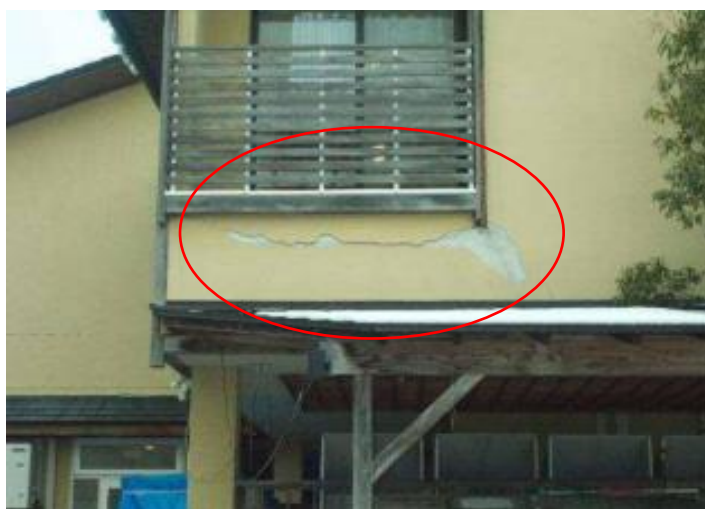
③ 外壁剥がれ
