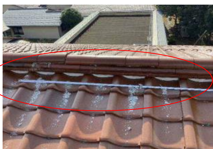
④ 棟 熨斗瓦の破損
