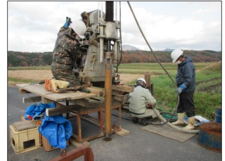
地下水の流向調査の状況 （写真は、米子市尾高・日下地内）
